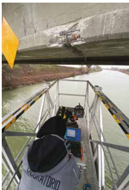
4A e 4B. Dettaglio (4A) e vista d'insieme (4B) della prova di rilascio tensionale su filo di precompressione
